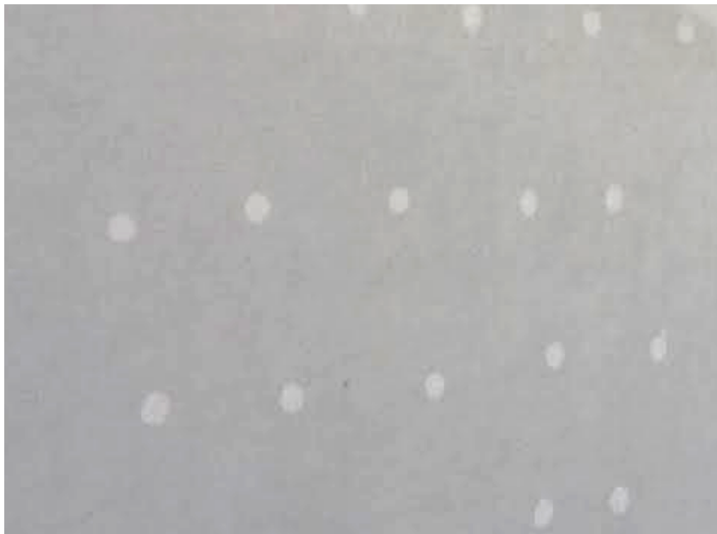
Punktowe zmiany barwy/odcienia ocieplonej elewacji, czyli tzw. Efekt biedronki
